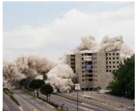
À la Cité Guillaume Apollinaire, 432 logements ont été démolis en 2001, laissant place à la reconstruction de nouveaux logements, locaux d'activités et équipements publics.
