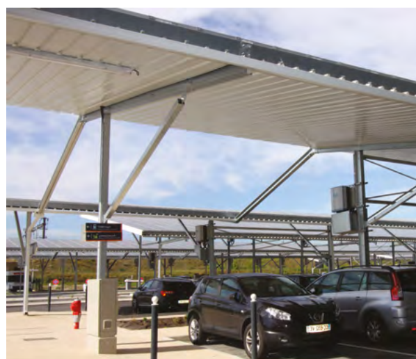
▲ Le parking P7 a dû fermer suite à l'effondrement d'ombrières photovoltaïques.
